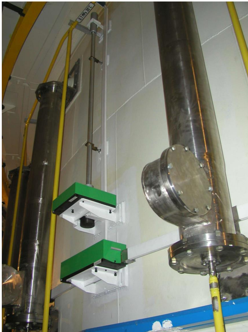
Obrázok: Pendametrický a hydronivelizačný snímač systému merania náklonu reaktora v atómovej elektrárni
